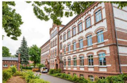
Denkmal mit Zukunft: Die 121 Jahre alte Grundschule wird umfassend saniert. Die ersten Arbeiten dafür waren bereits 2019 in Angriff genommen worden.
