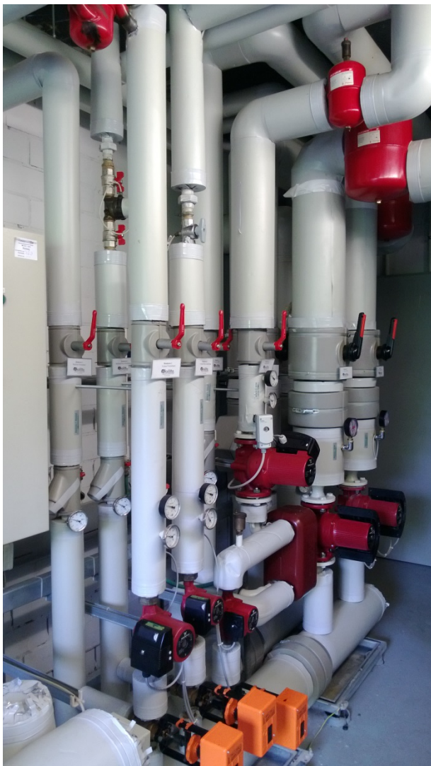
Heizungsverteiler in sehr gutem Zustand
