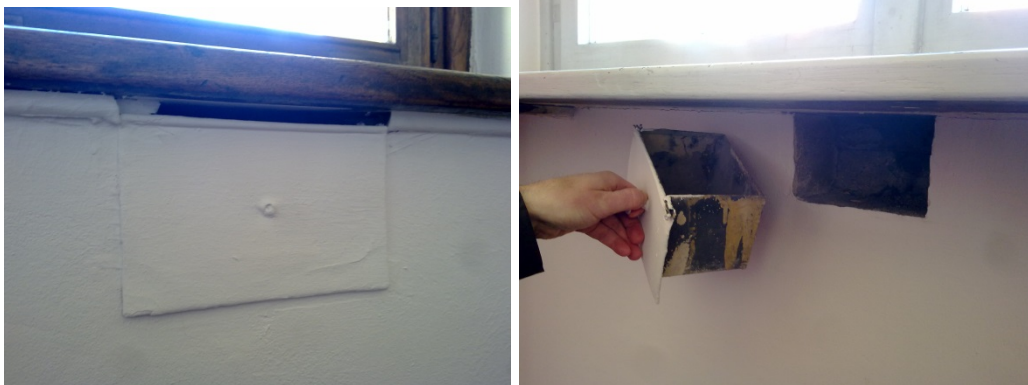
Alte Wasserfangkästen unterhalb der Fensterbänke bilden Kältebrücke
