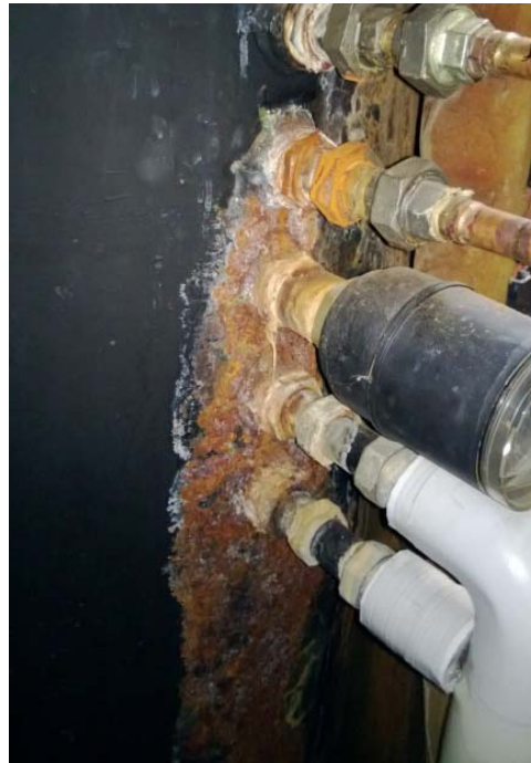
Roststellen am Speicher
