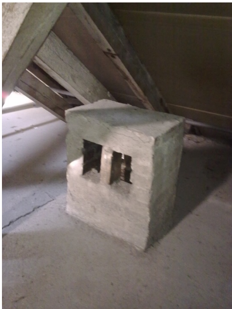
Offene Lüftungsschächte im Dachraum
