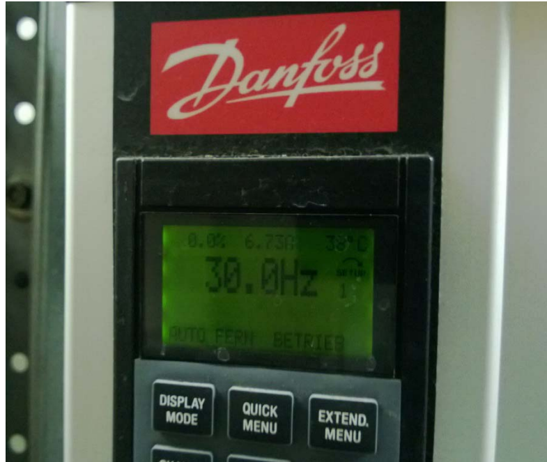
Frequenzumrichter für Beckenwasserpumpen im reduz. Betrieb
