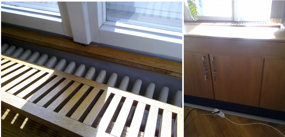
Eingebaute Heizkörper Büro 217
