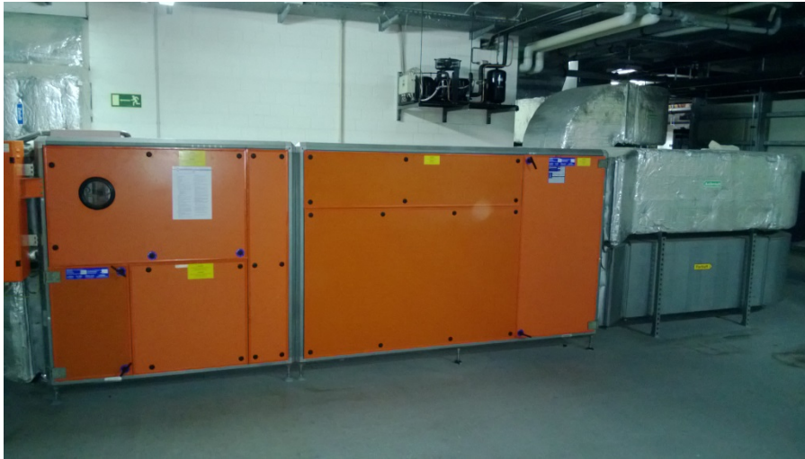
Lüftungsanlage und -kanäle in sehr gutem Zustand
