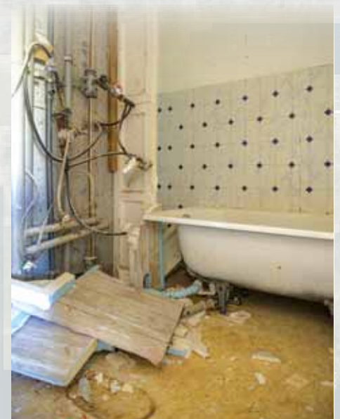
Einmal alles rausreißen bitte: Zum Baustart in der Havellandstraße mussten Vorschlaghammer und Kettensäge ran. Foto: Thomas Matena
