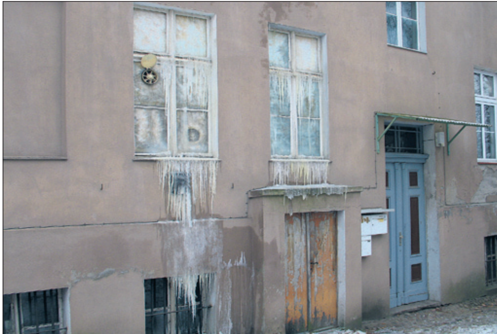
Ein seltener Anblick, doch gefährlich für das Gebäude: Frostschäden an einem Mauerwerk.
