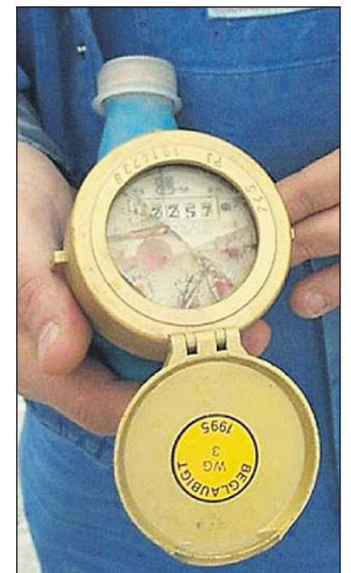
Ausgewechselter, vom Frost zerstörter Wasserzähler
