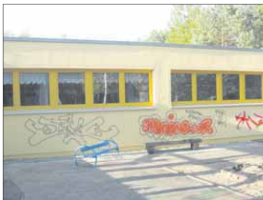
Neue Kita-Fassade – gleich beschmiert!
