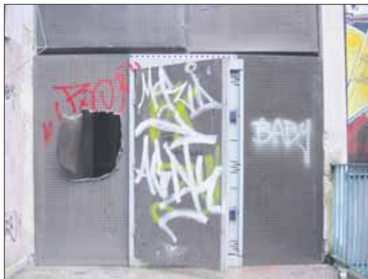
Wohin mit zuviel Kraft? Purer Vandalismus an einem bereits gesicherten Objekt.
