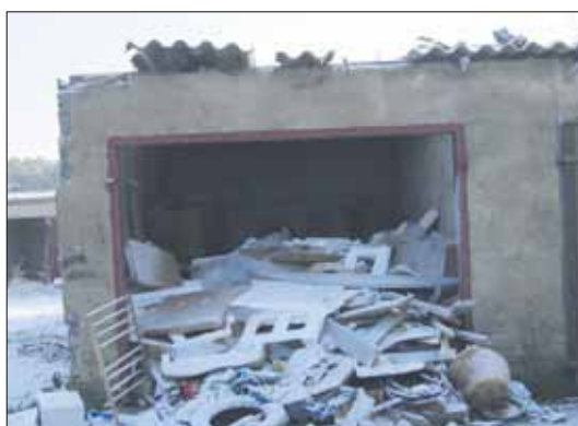
Komplett vermüllte Garage (ruine!). Hier kann nichts mehr vermietet werden.
