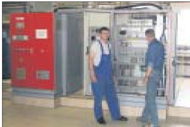
BHKW Kläranlage Eberswalde
