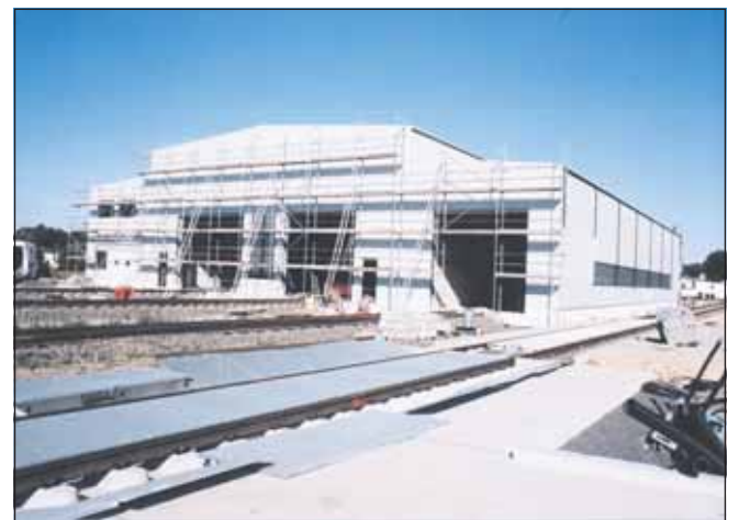
Blick auf die künftige ODEG-Betriebswerkstatt auf dem ehemaligen Oberbauwerk in Kupferhammer. Foto: Stö.-
