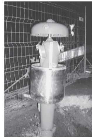
Von diesem Hydranten gibt es noch einen auf der anderen Brückenseite. Sie wurden vom ZWA errichtet.
