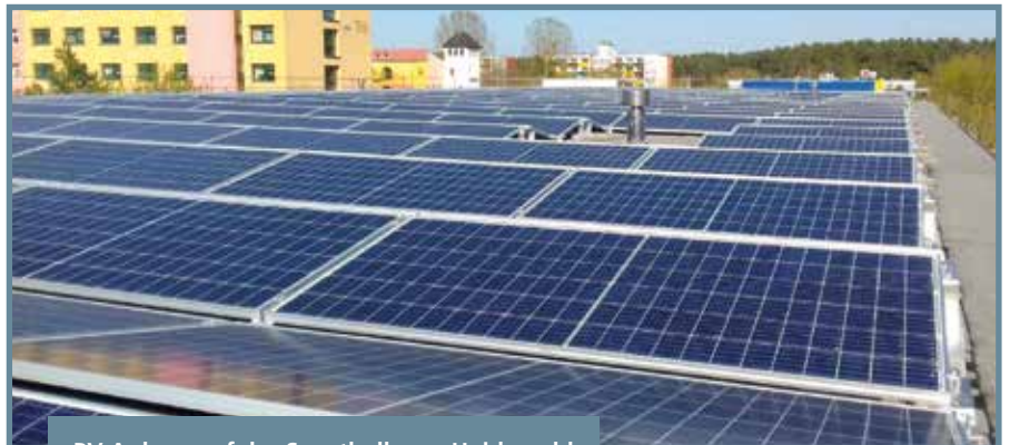
PV Anlage auf der Sporthalle am Heidewald
