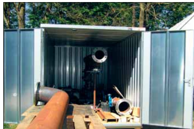
„Übergangsherberge“ für die Reinwasserpumpen
