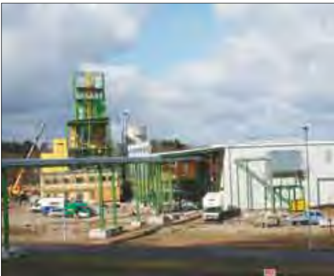
Im Bau: Das neue Holz-Pelletierwerk am Hafen wird Mitte April in die Produktionsphase übergehen.
