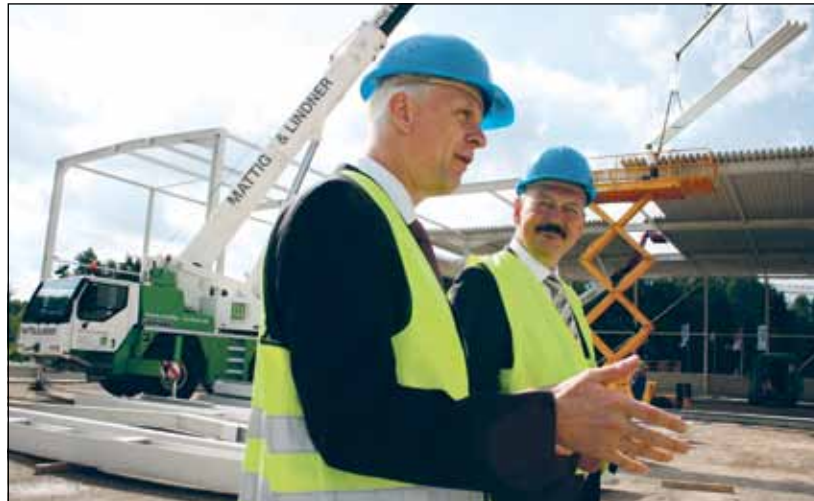
Werksleiter Jens Ebert führte Bürgermeister Friedhelm Boginski über die Baustellen der neuen Lagerhalle auf dem Werksgelände des Verpackungsherstellers.
