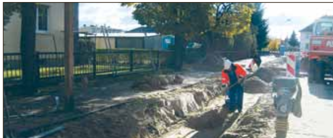
Der Kanal in der Neuwerkstraße ist verlegt, nun wird der Graben wieder geschlossen.
