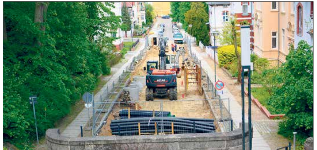
Statt Autos rollen Bagger und Radlader durch die Schillerstraße. Die Anliegerstraße im historischen Villenviertel wird im Laufe eines Jahres komplett saniert.
