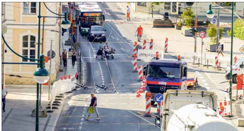
Mit der Fertigstellung der Arbeiten entlang der Breiten Straße und an der Friedensbrücke wurde auch der Radweg vervollständigt. Damit können Radfahrer die Straße und Kreuzungsbereiche passieren.
