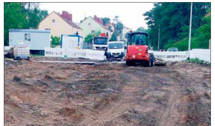
Der Startschuss für die Bauarbeiten des ersten Bauabschnitts in der Fritz-Weineck-Straße ist Mitte Juni gefallen.
