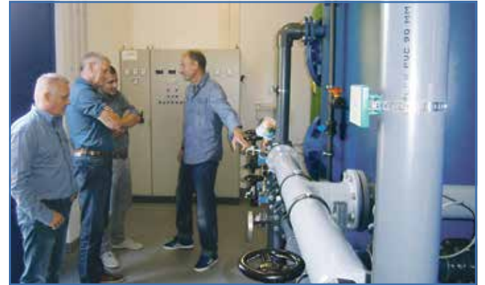
Blick ins Wasserwerk Tempelfelde (v.r.n.l.) Vorarbeiter Wasserwerke Frank Boden, Vorsitzender der Verbandsversammlung André Nedlin, Technischer Leiter Volker Pagel, Leiter Bereich Trinkwasser Ronny Seeger Foto: ZWA
