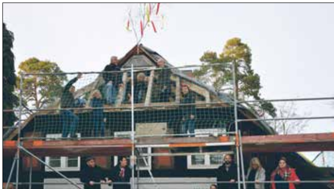
Der letzte Nagel für das neue Dach des zukünftigen Stiftungshauses ist eingeschlagen.
