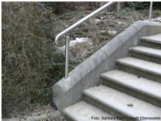
☹️ Handlauf aus Edelstahl-Rundrohr, allerdings nicht weit genug geführt (Unfallgefahr)
