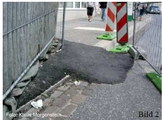
☹️ Ungeeignete „Baustellensicherung“ im Gehwegbereich, Unfallgefahr
