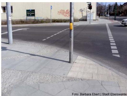
☹ Fehlerhaft angelegte Bodenindikatoren, Gefahr der Kollision mit Radfahrern bzw. Kraftfahrzeugen
