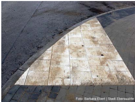
☹ Zu großer Einmündungsradius, Querungsstelle zu nahe an, Straße, Unfallgefahr
