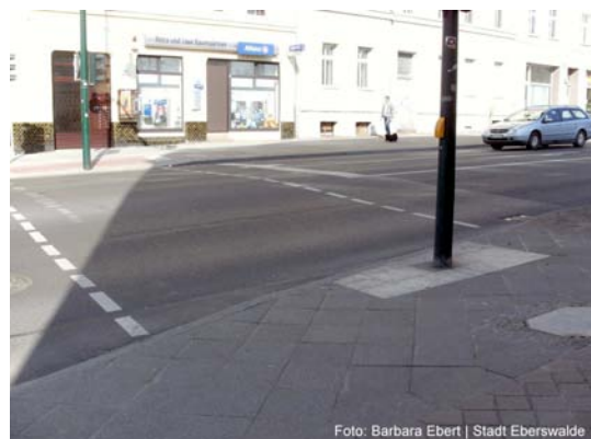
☹ Fehlerhaft angelegte Bodenindikatoren und angebrachte Bedienelemente
