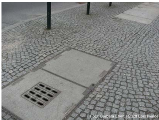
☹ Unterbrechung der Gehbahnmarkierung - fehlende Mobilitätskette
