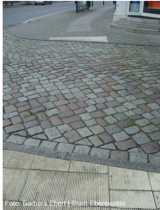
☹ Querungsstelle mit diagonal und breitfugig verlegtem Pflaster
