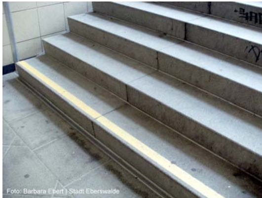
☹️ Stufenmarkierung auf Austrittsstufe - allerdings nur auf der Trittstufe
