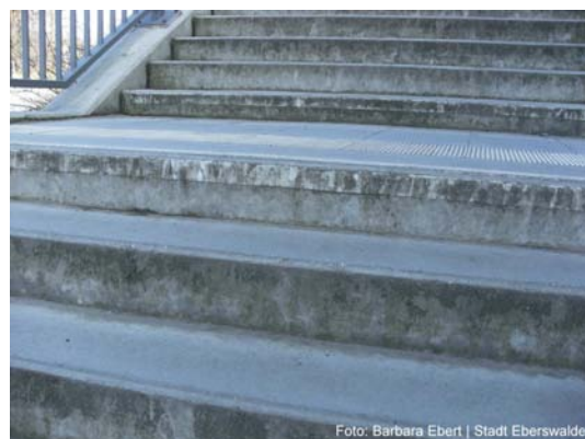
☹️ Stufenmarkierung nicht mehr erkennbar
