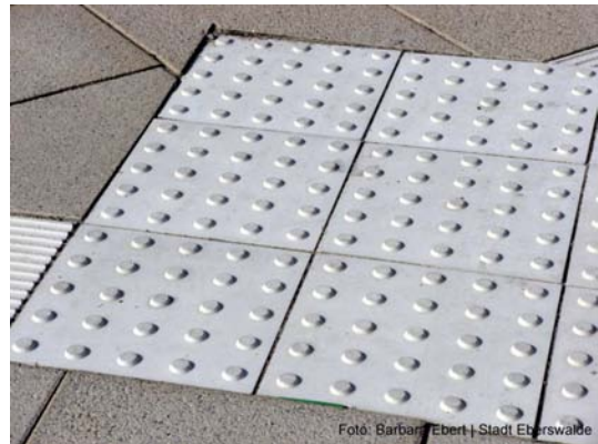
☹ Bodenindikatoren, nicht fachgerecht verlegt: Funktionsverlust
