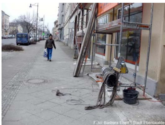
☹️ Ungesicherte Baustelle im Gehwegbereich
