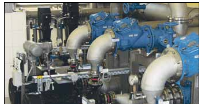
Moderne Wassertechnik stellt auch künftig die Versorgung mit qualitativ hochwertigem Trinkwasser sicher.
