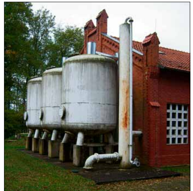
Außenstehende Filterkessel am Wasserwerk - dieser Anblick gehört bald der Vergangenheit an.
