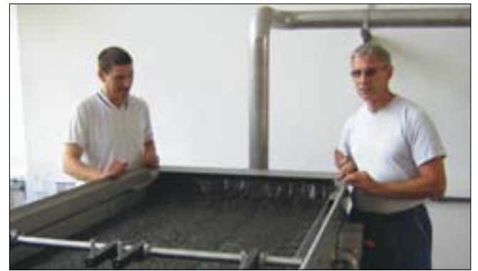
Die Mitarbeiter Hartmut Christmann und Jürgen Kumm am neuen Bändeindicker für Überschussschlamm auf der KA Eberswalde.
