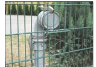
Es ist oft nicht leicht, abflusslose Sammelgruben zu erreichen. Doch das Abpumpen der Fäkalien kann auch vom öffentlichen Verkehrsraum aus erfolgen. Ein Anschlussstutzen an der Grundstücksgrenze löst Anfahrtsprobleme und bringt Vorteile für Grundstückseigentümer. Sie müssen nicht mehr zu Hause sein, um die Zufahrt zur Grube zu gewährleisten.
