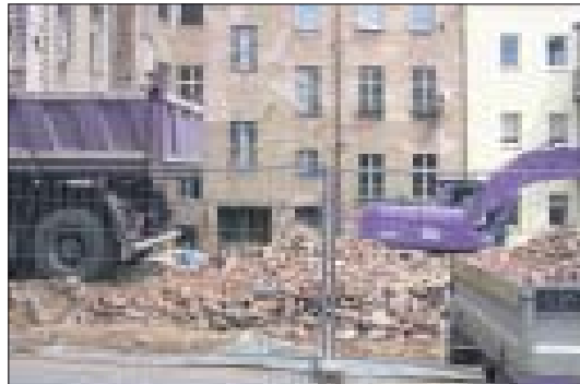
Mit Abriss- und Entkernungsarbeiten startete das Vorhaben Villa Victoria in der Rudolf-Breitscheid-Straße. Foto: WHG
