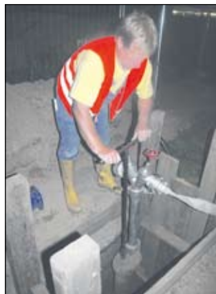
Norbert Gärtner baut den Rest-Druck ab. Die Schieber sind bereits geschlossen.
